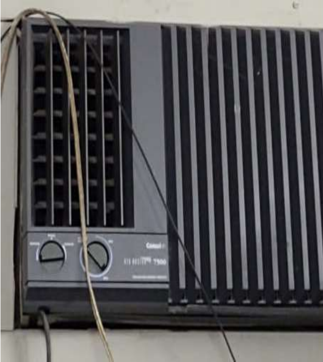
Foto 13 - Ar condicionado Consul 750 btus
